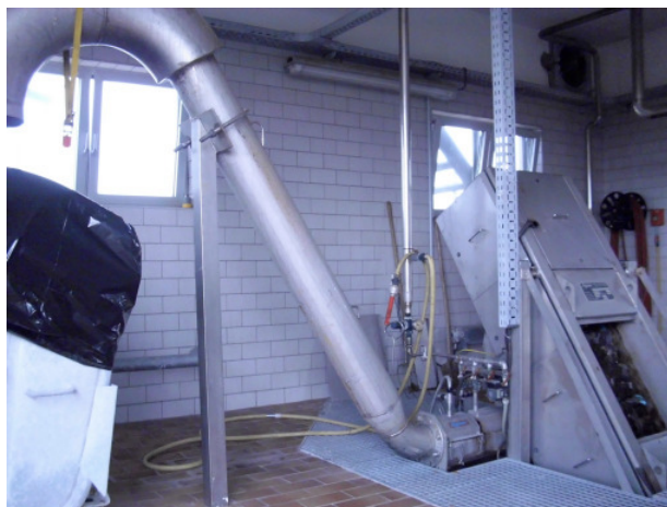
Filterstufenrechen und Rechengutwäscher
