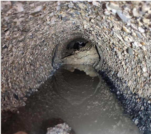
Foto: maroder Betonkanal (Blick ins Innere)
