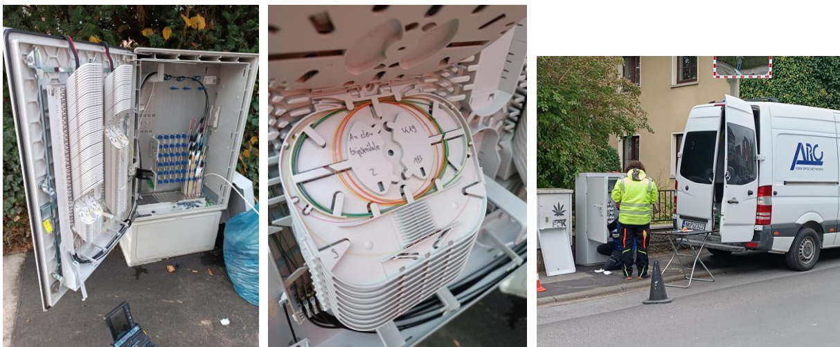
neuer Glasfaser-Verteilerkasten, einzelne Glasfasern zum Haus und Einblasen der Glasfaserkabel
