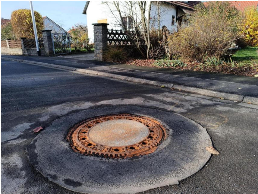
Beispiel einer Schachtregulierung in Bad Königshofen (Deckel ist neu!)
